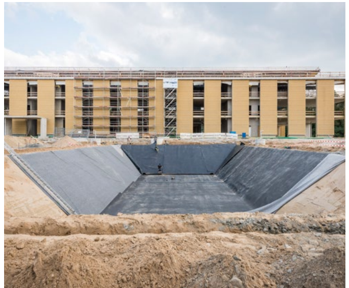
Von einer Million Liter Wasser, die in der Rigole gespeichert werden können, werden 25 Prozent für die selbstständige Löschanlage zurückbehalten. Das restliche Wasser steht als sogenanntes Grauwasser zur Nutzung zur Verfügung und dient unter anderem zur Nachspeisung des Teichs auf dem Gelände.
